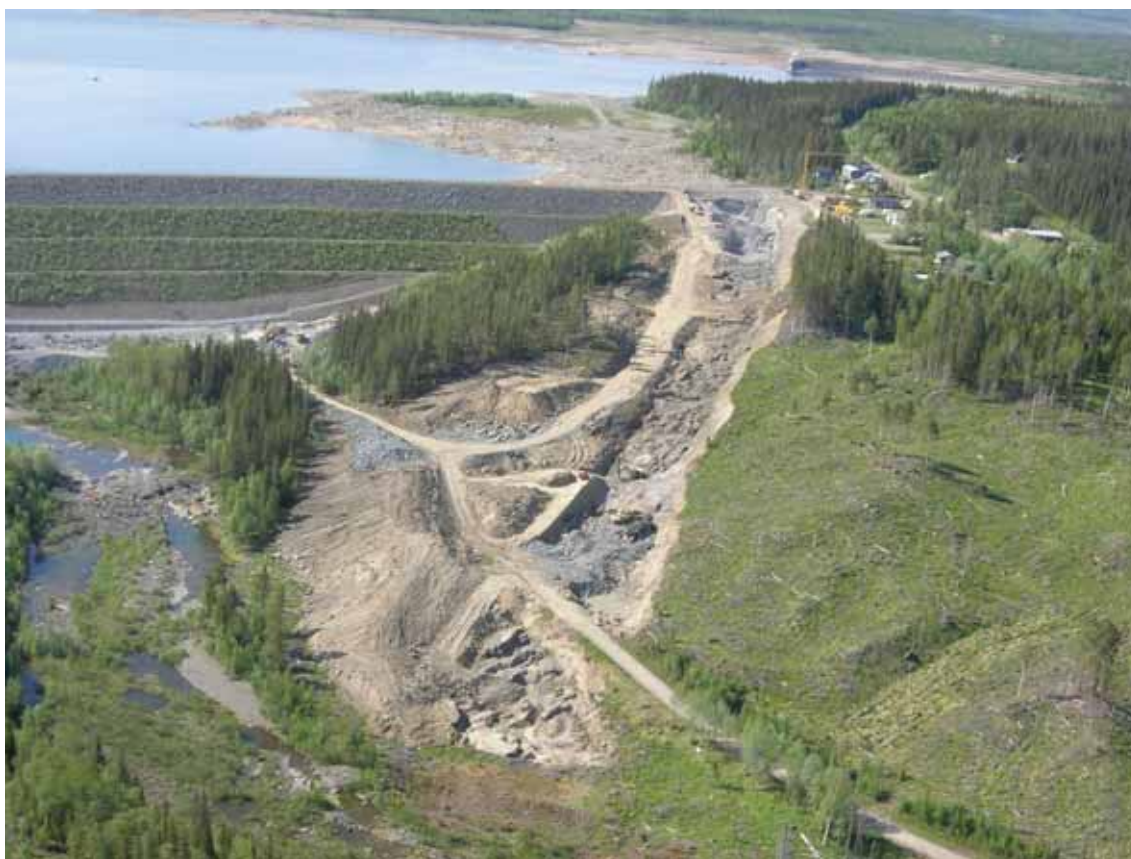
Figur 5. Ombyggnadsarbeten för att förse Håckrendammen med ett nytt utskov och därigenom ytterligare höja säkerheten. (Foto: Vattenregleringsföretagen, 2006)
